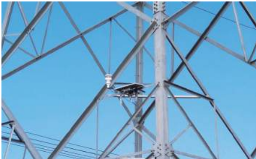
微气象在线监测装置现场安装图
